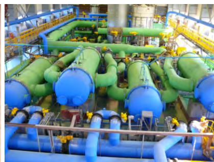
Оборудование промежуточного контура охлаждения
